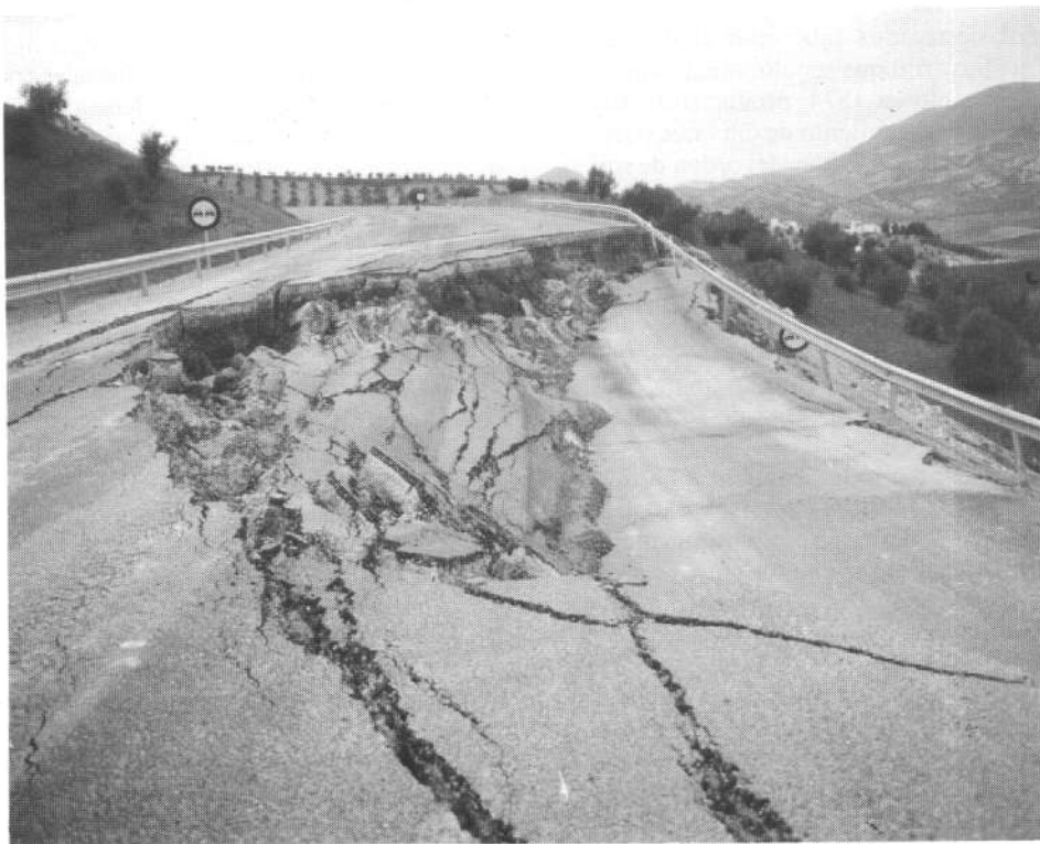
Deslizamiento afectando a una carretera en el Puerto de Carretero (Jaén). Foto cedida por G. Garzón.
